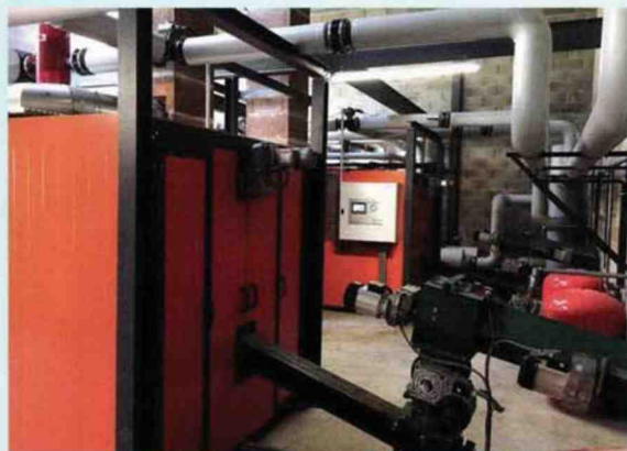
Deux chaudières biomasse Heizomat RHK-AK 500 assurent le chauffage des poulaillers.
